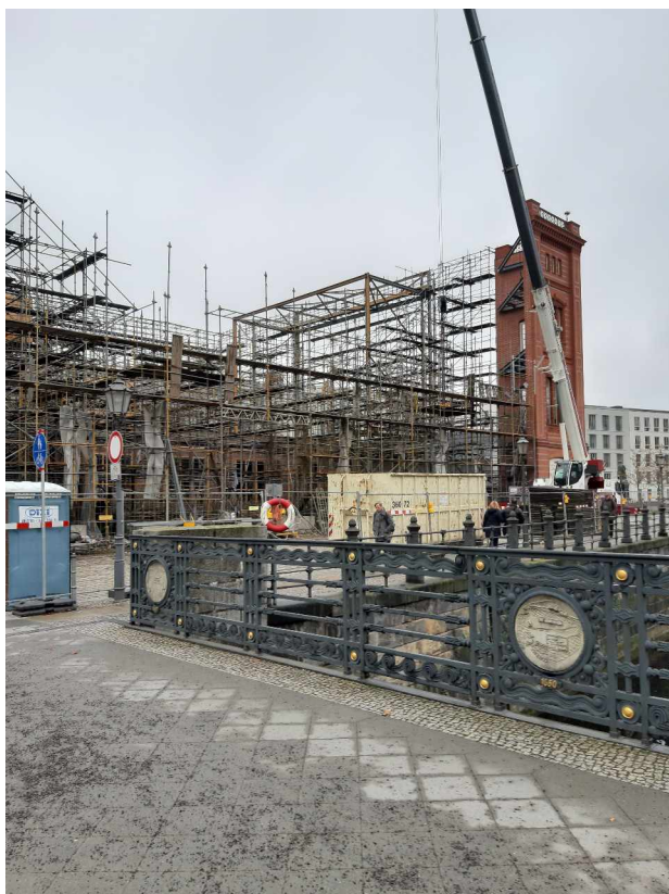
Abbau des Gerüsts der Bauakemiesimulation. Austausch eines motivgleichen Fotos in der Morgenpost (Foto: W. Schoele)
